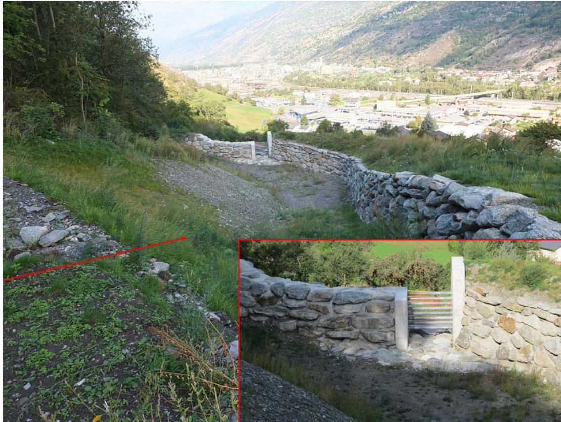
Figur 60. Det nederste bassenget har som formål å fange finere og slamførende masser som blir sluppet gjennom den øverste fangdammen. Rød strek viser skredretning (Foto: Audun Langelid og Gunne Håland)
