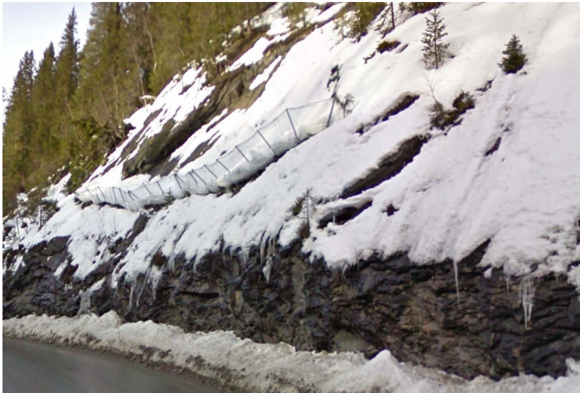
Figur 86. Snøsigproblemer over vegskjæring ved Svølgja i Sør-Trøndelag (Foto: Google street, 2010)
