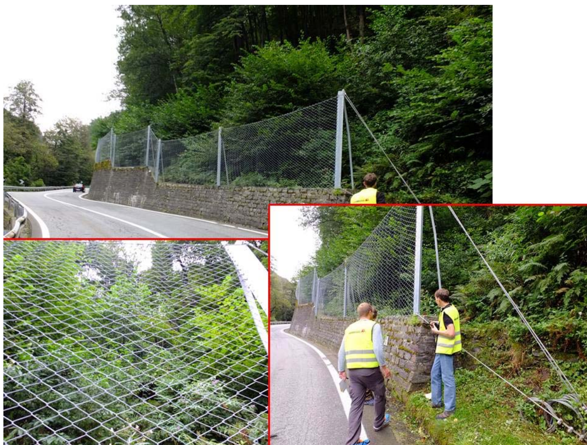
Figur 41. Fanggjerdet på 100 kJ med Tecco - sikringsnett (Foto: Gunne Håland)
