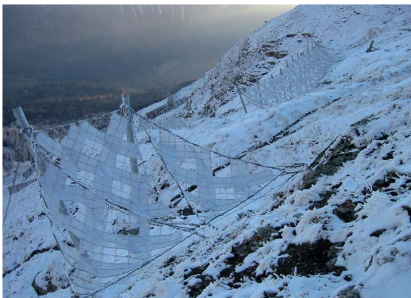
Figur 27. Snøgjerder som støtteforbygning i løснеområdet (Foto: Geobrugg)
