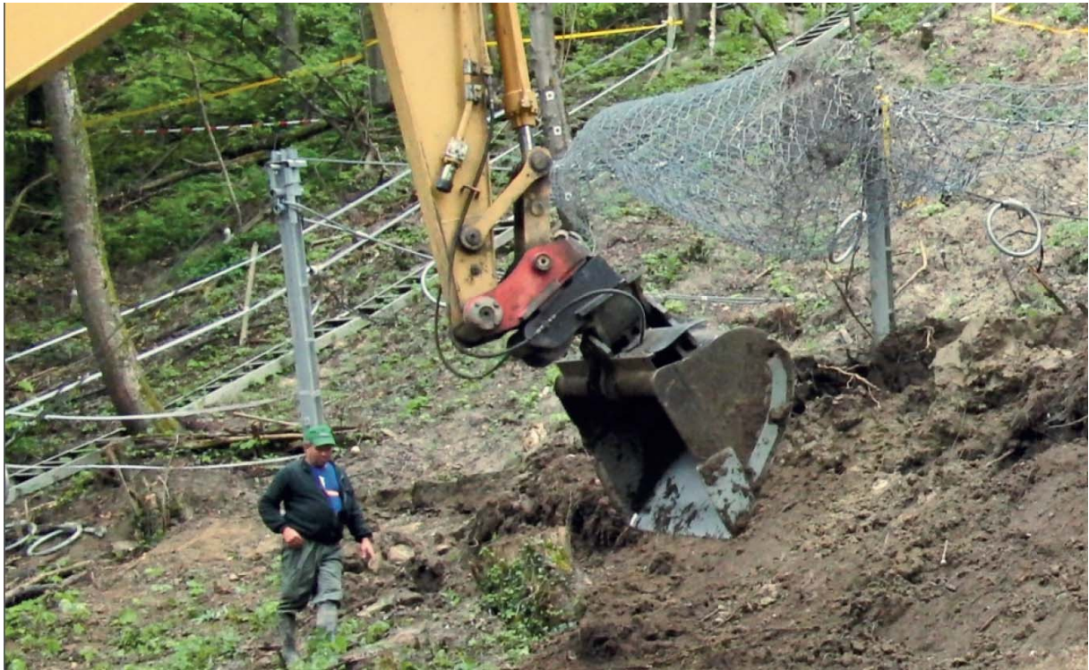
Figur 31. Et eksempel på hvordan man kan fjerne massene fra nedsiden på et fleksibelt fanggjerde mot jordskred (Foto: Geobrudd)
