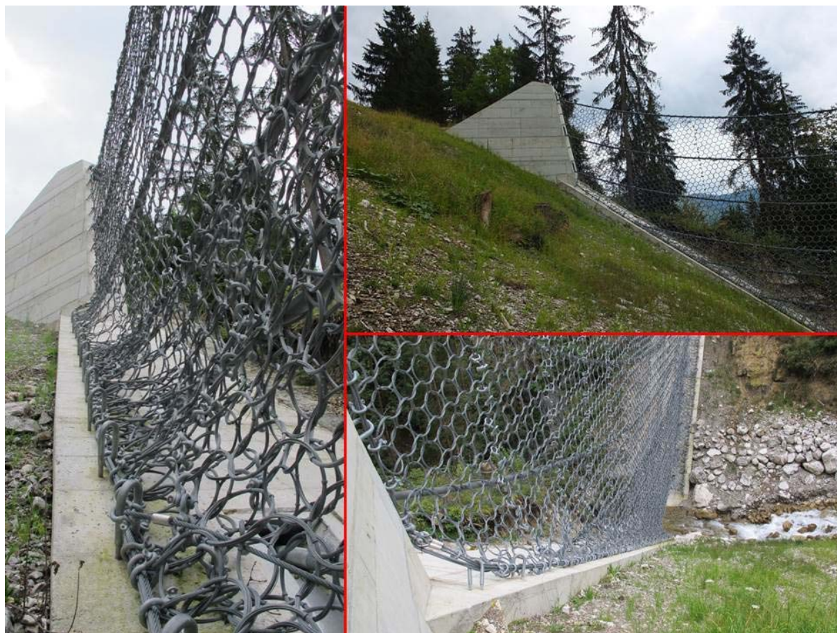
Figur 71. De nederste 9 meterne består av et dobbelt lag med ringnett. De 9 bærewirene er forankret i støpte betongelementer langs kanalveggene. Nederst er det en åpning slik at elven kan strømme fritt gjennom uten å berøre gjerdet (Foto: Gunne og Audun)
