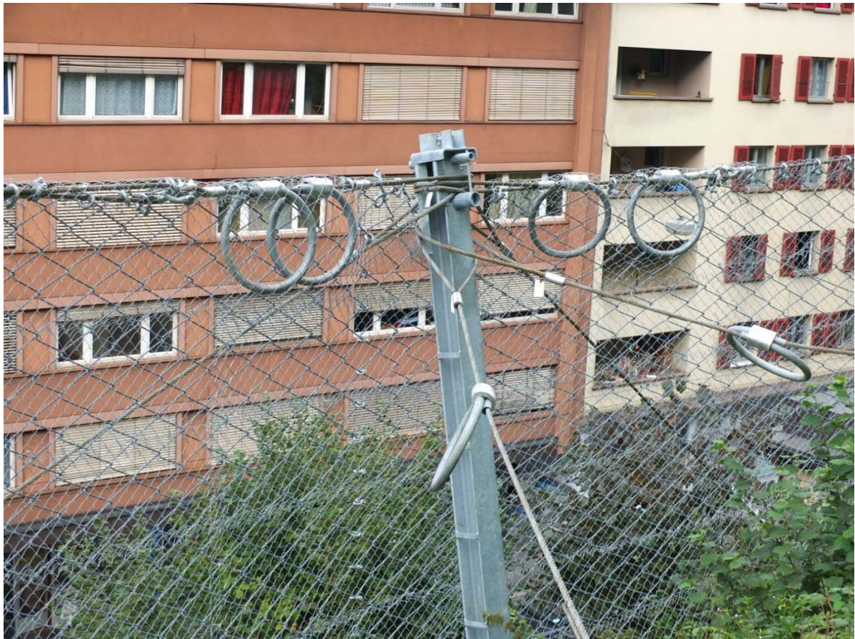
Figur 81. Både de langsgående bærewirene, og støttewirene som er festet til stolpene har bremsringer. Gjerdene har Spider sikringsnett og et vanlig flettverksnett som innernett (Foto: Gunne Håland)
