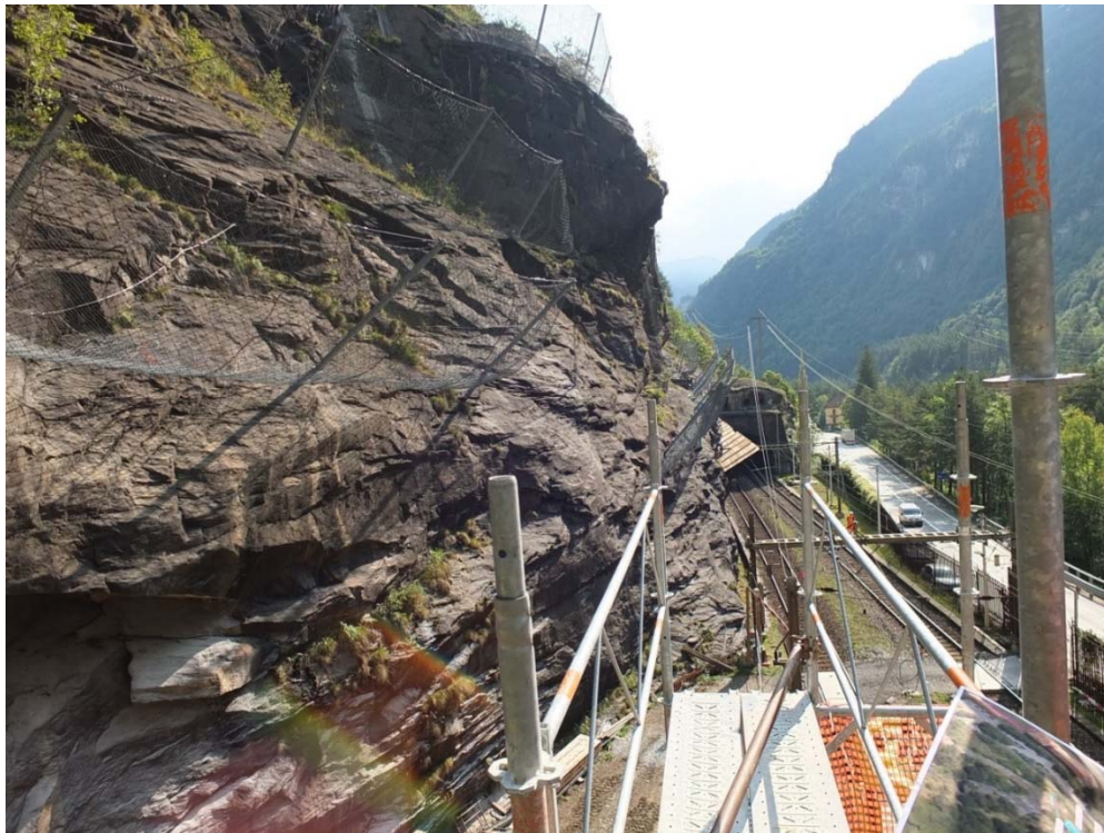
Figur 44. Det er installert flere ulike typer fanggjerdar mot steinsprang i den bratte fjellskrenten over jernbanestasjonen (Foto: Gunne Håland)
