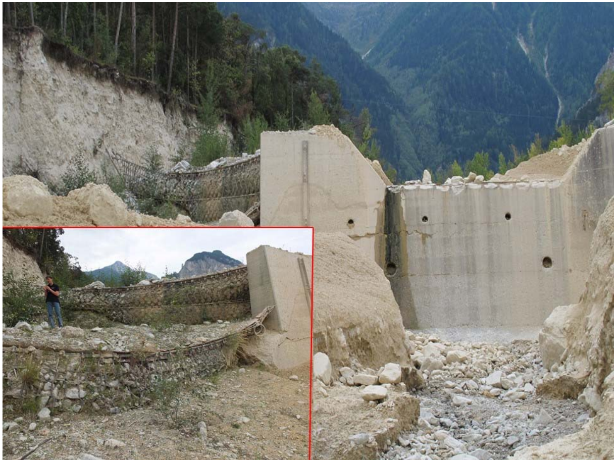
Figur 64. Her har skredløpet blitt sikret med en åpen kontrolldam i betong og to fleksible flomskredgjerder. Gjerdene har hatt god sikringseffekt mot flomskred (Foto: Gunne Håland og Audun Langelid)
