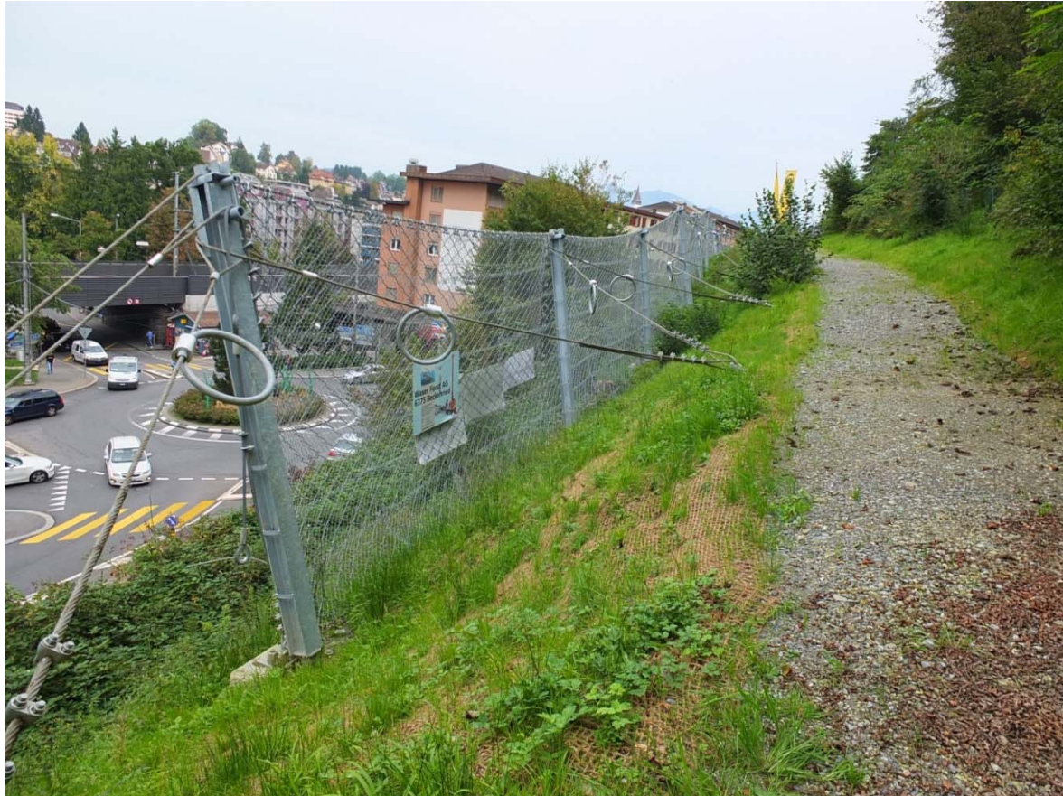
Figur 79. Det er satt opp et fleksibelt fanggjerd for å sikre en rundkjøring og noen bygninger mot jordskred (Foto: Gunne Håland)
