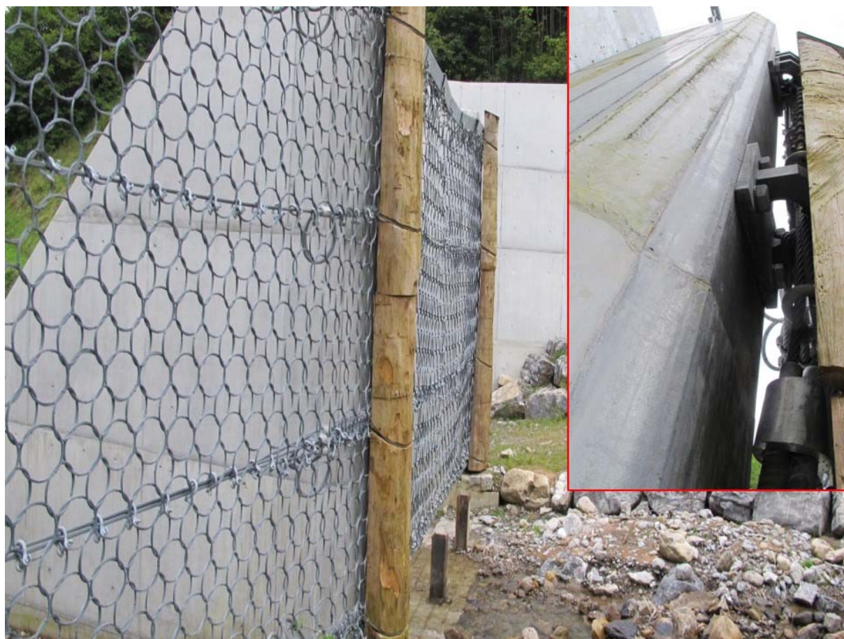
Figur 74. Tømmerstokkene beskytter betongkonstruksjonene mot skredmassene (Foto: Audun Langelid)
