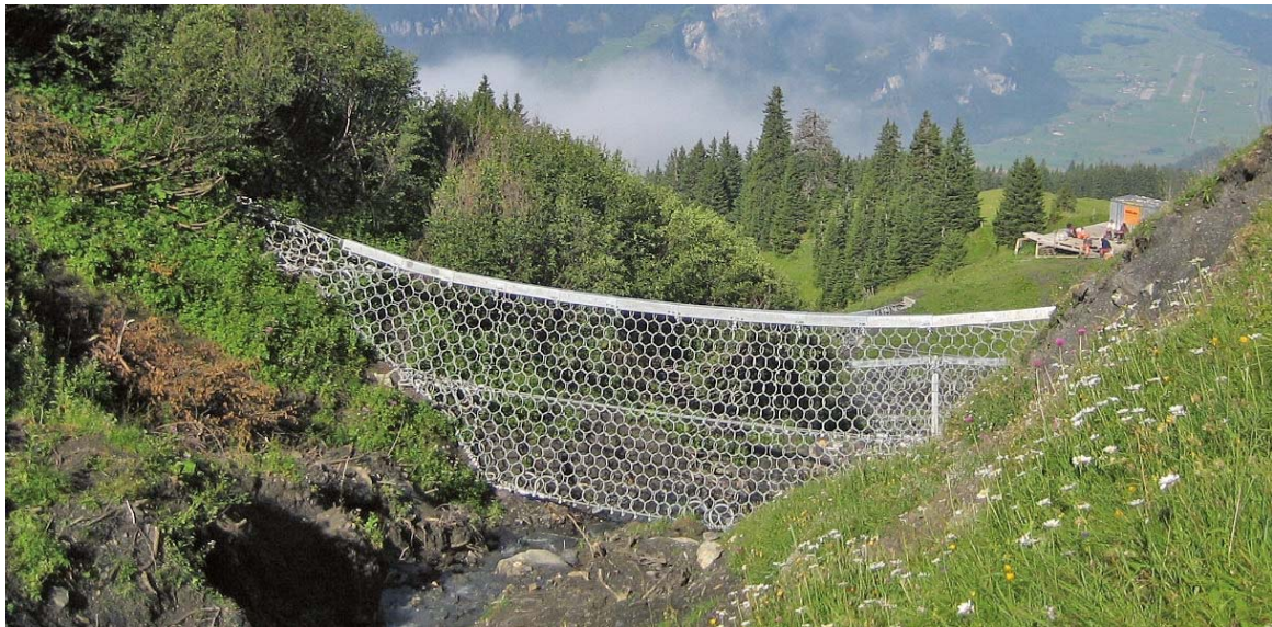
Figur 14. Et eksempel på et fleksibelt ringnett-gjerde som er installert i en smal V-formet kanal (Foto: Geobrugg)
